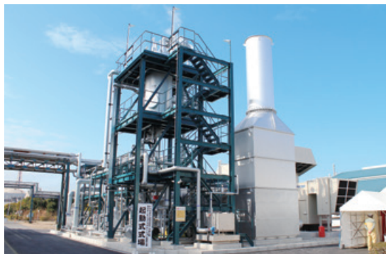
ガスタービン コージェネレーション設備の全体像
