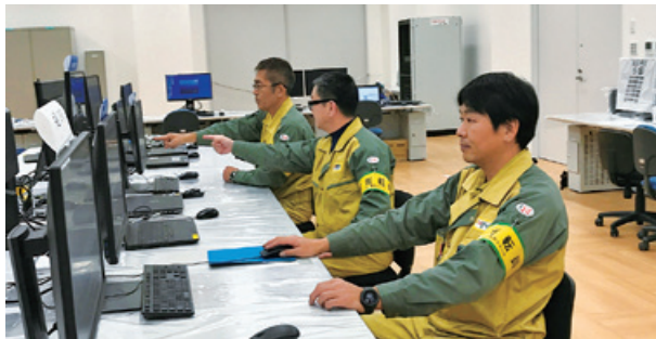
中央操作室にて試運転業務実施
