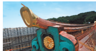
更新後の避雷設備
