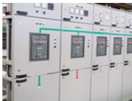
制御盤・計装盤
