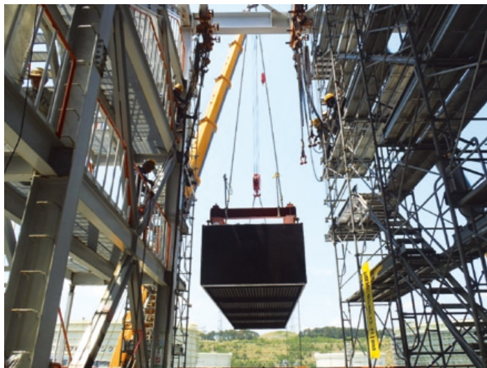
東京電力(株)広野火力発電所 GGH熱回収器バンドル取替
