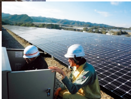
千葉県鴨川市（出力9MW）
