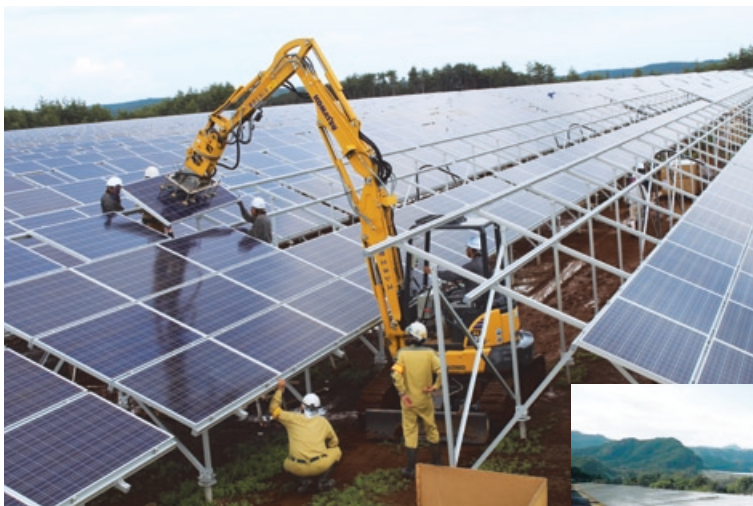
石川県志賀町（出力5.8MW）
