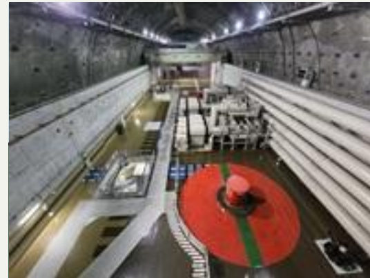
神流川発電所 (写真:東京電力リニューアブルパワー様提供)
