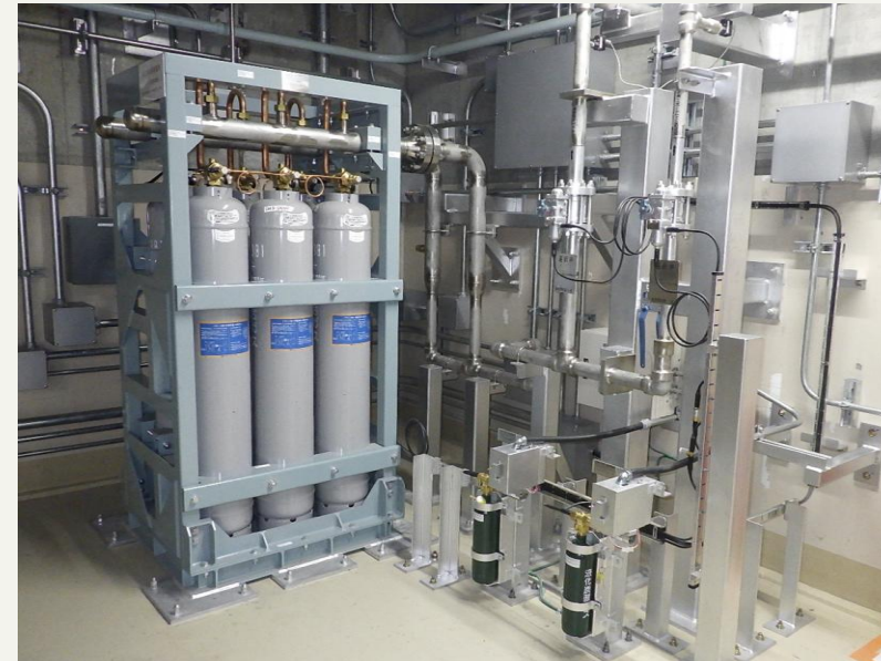
東北電力様 女川原子力発電所2号機
