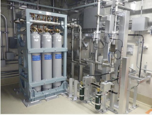
東北電力様 女川原子力発電所2号機
