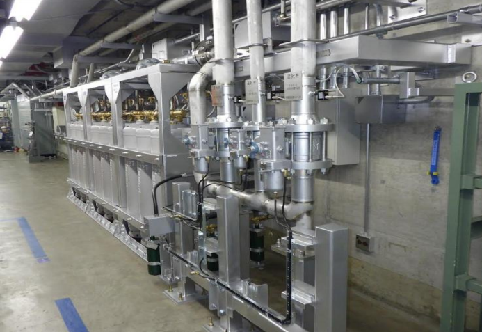
東京電力ホールディングス様 柏崎刈羽原子力発電所6, 7号機
