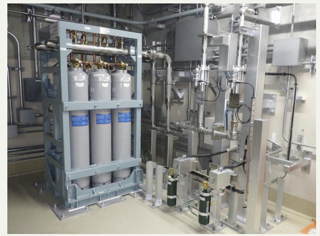
東北電力様 女川原子力発電所2号機
