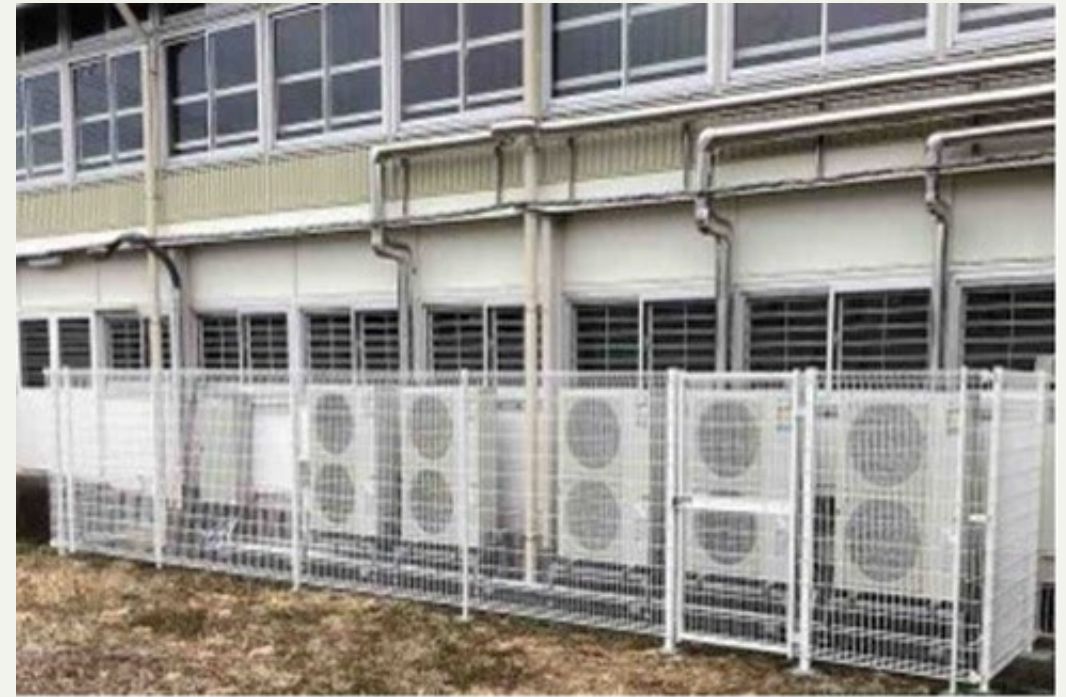
空調設備の設置例（室外機）
