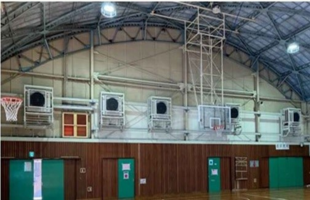
空調設備の設置例（室内機）
