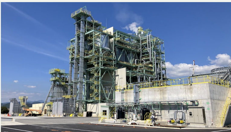
日向バイオマス発電所 2024年10月16日運転開始 出力規模：50000kW 受注内容：O&M、LTSAなど
