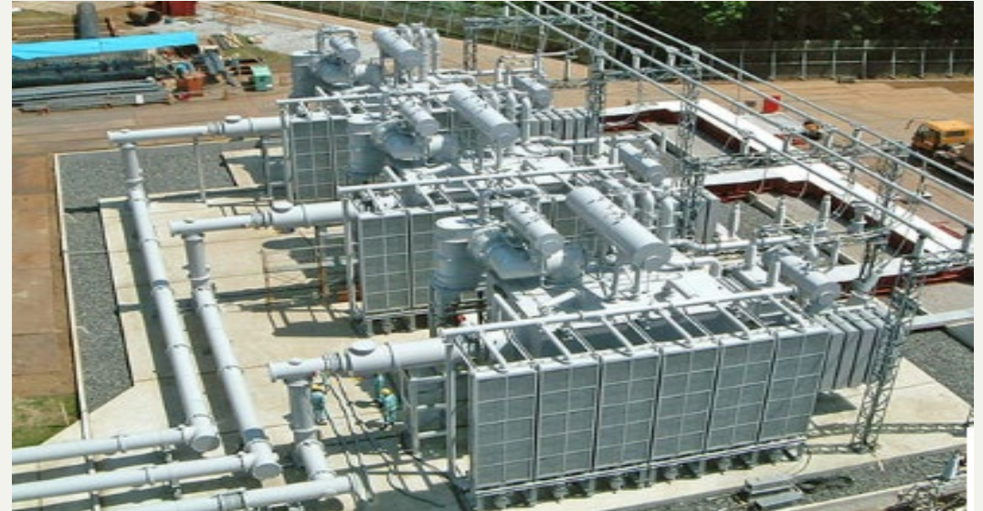
超高圧変電所（イメージ）
