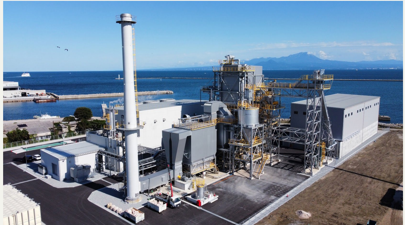
境港バイオマス発電所全景
