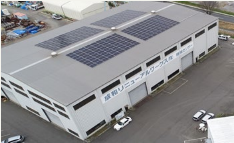
屋根上太陽光設備
