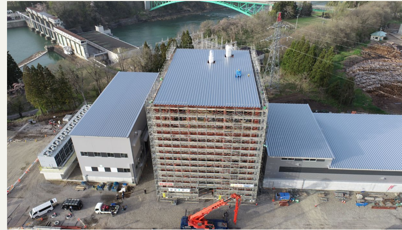
会津こもればいバイオマス発電所 2024年12月営業運転予定
