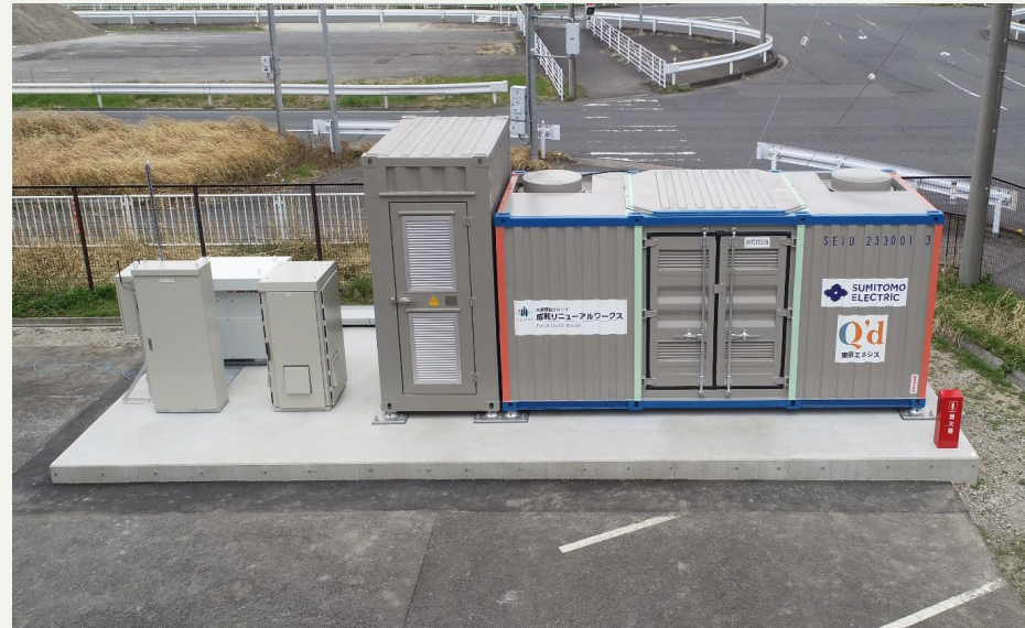
レドックスフロー電池
