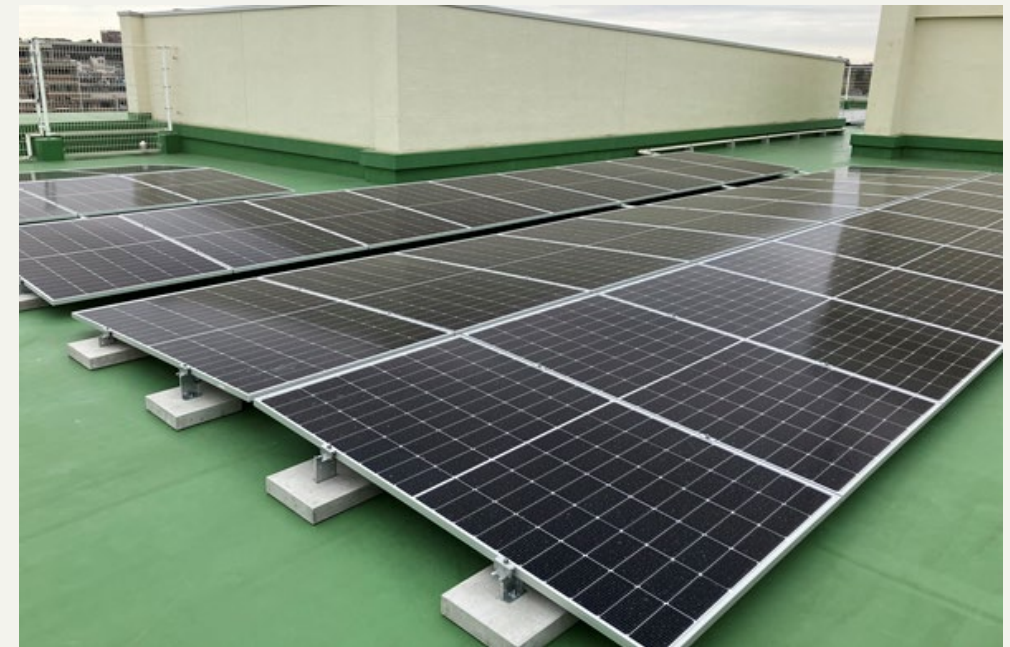
屋上太陽光設備
