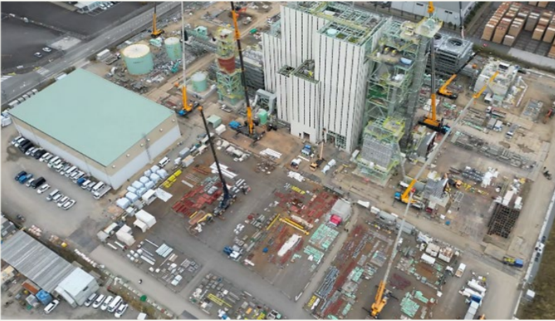
日向バイオマス発電所 2024年11月営業運転予定
