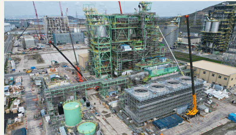
田原バイオマス発電所 2025年4月営業運転予定
