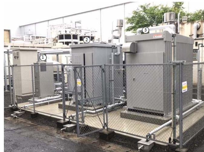
P 2 Gシステム利用設備
