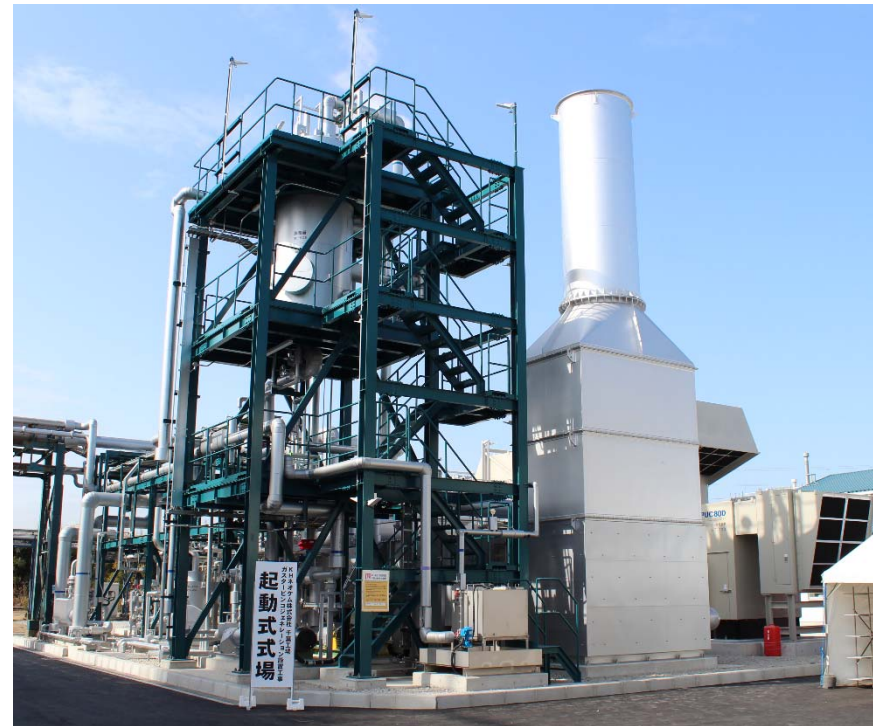
ガスタービンコージェネレーション設備
