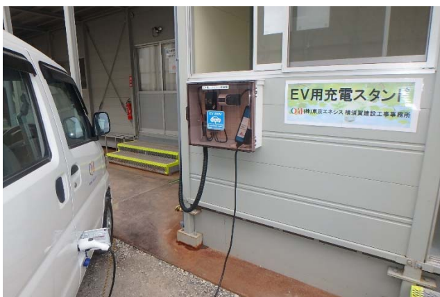
EV車・充電スタンド
