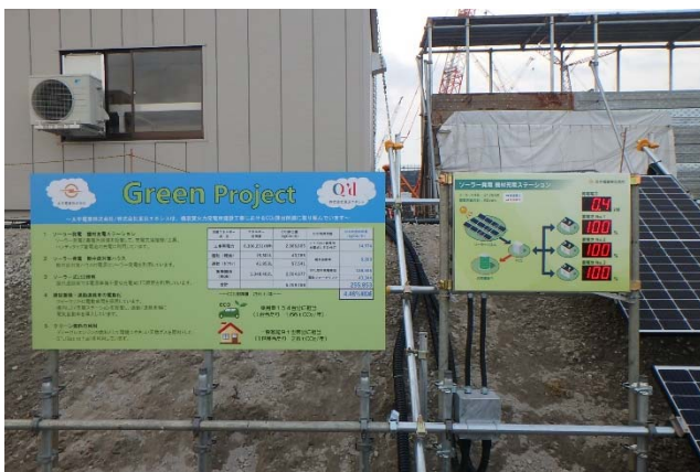
Green Projectに関する現地案内板
