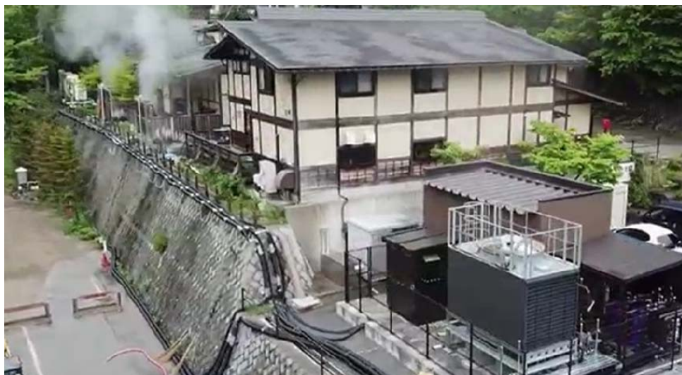
発電所の全景
